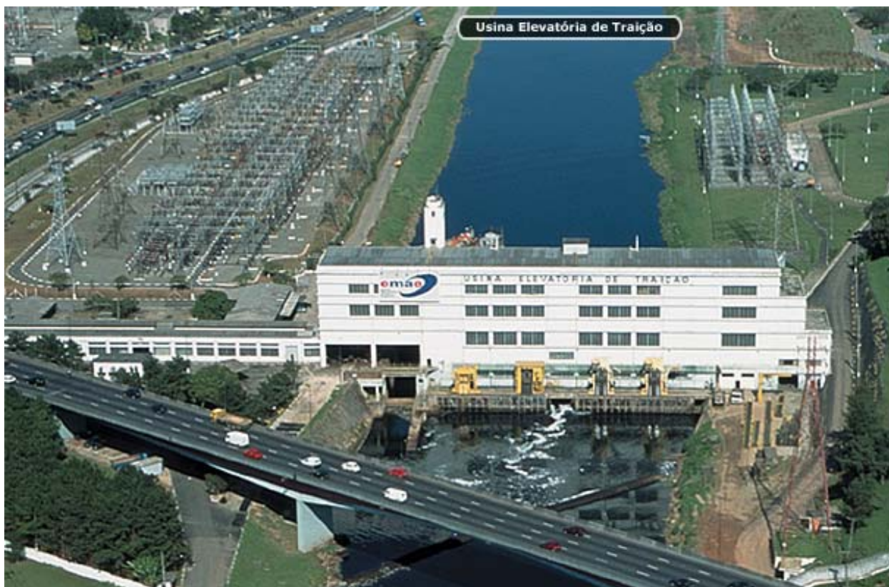
USINA ELEVATÓRIA DE TRAIÇÃO - UNIDADE IV
